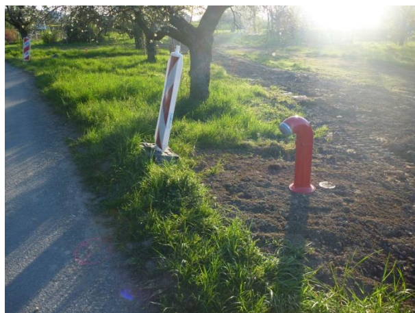
nouvelle borne hydrante, La Tuilière à Vinzel
