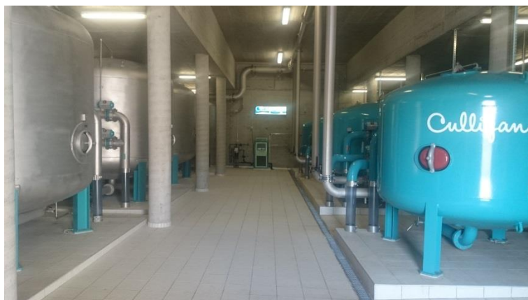
station de filtration de Champ Jaillet
