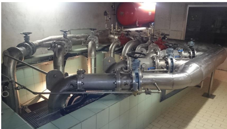
station de pompage au lac de l'Oujonnet
